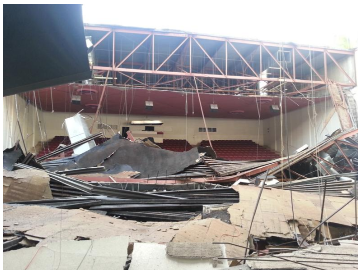
Слика 1.0 – Срушен кров школске сале услед ветра и кише у САД-у
