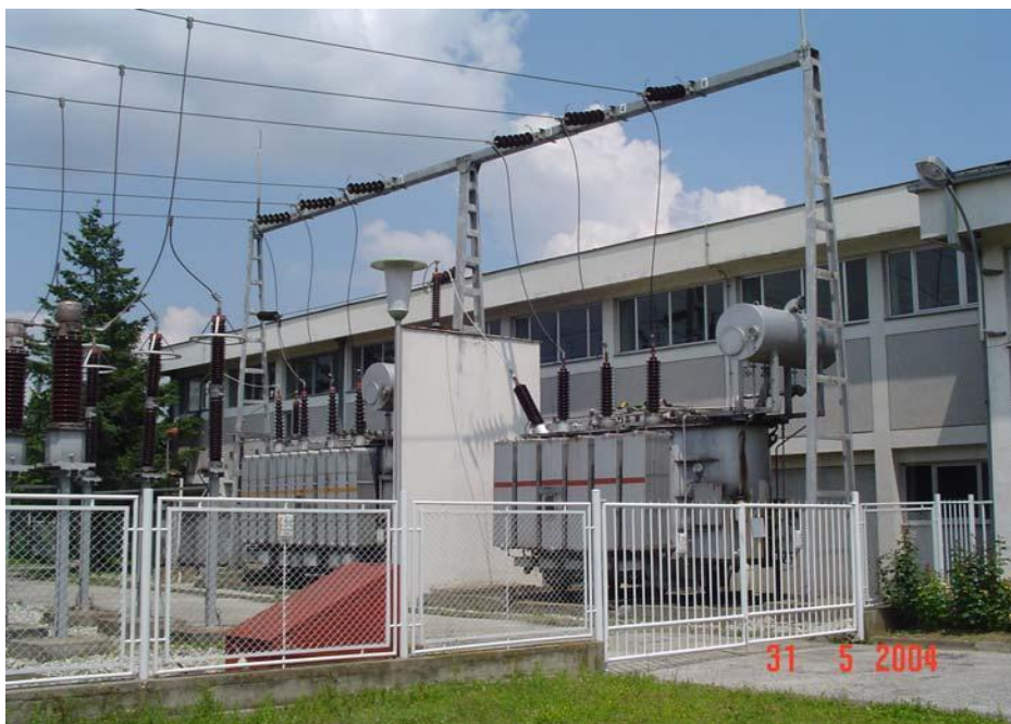
Слика 4. Изглед енергетског објекта за пренос струје
