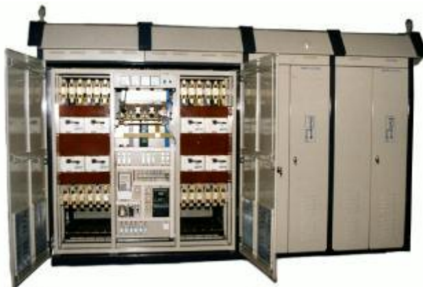
Слика 10. Пример блиндиране трафо станице
