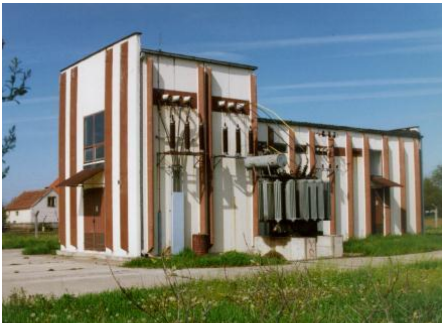
Слика 8. Пример трафо станице у бетонским или зиданим кућиштима
