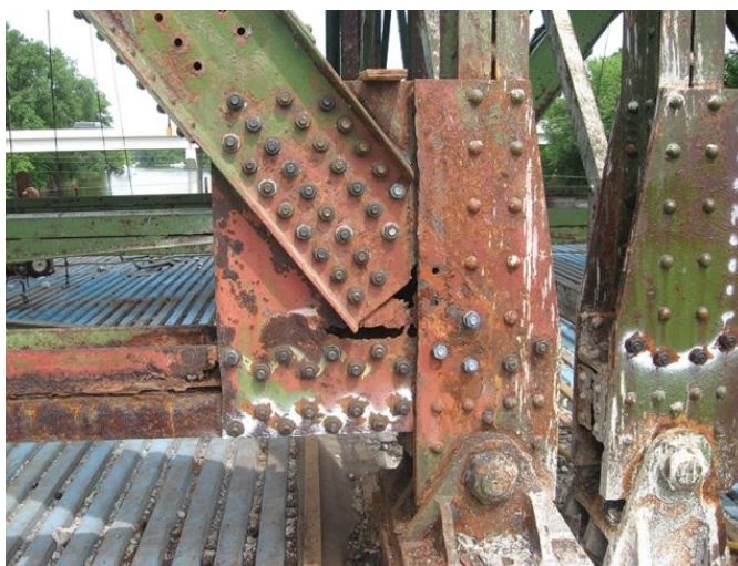
Слика 6: Пример моста захваћеног атмосферском корозијом [8]
