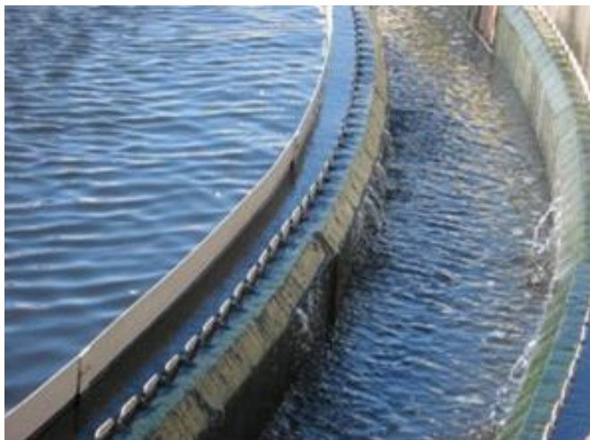
Слика 6.5. Одвајање воде од муља у секундарном таложнику [14]
