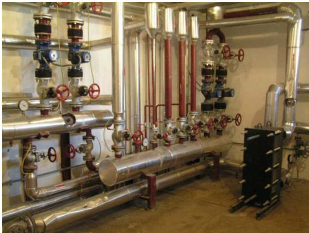
Слика 6: Топлотна подстанција
