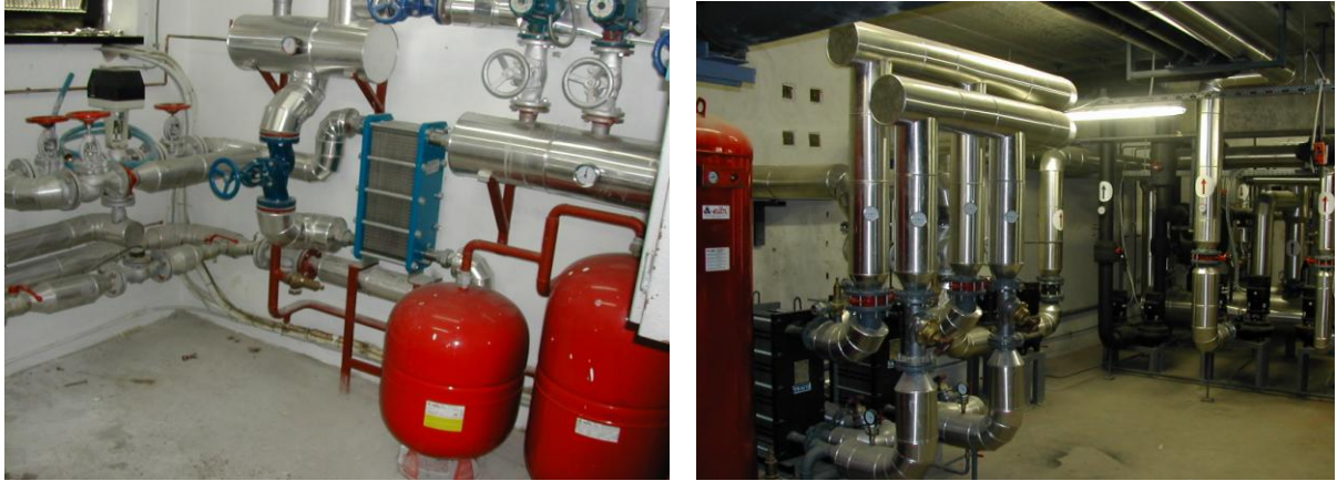
Слика 2: Изглед подстанице
