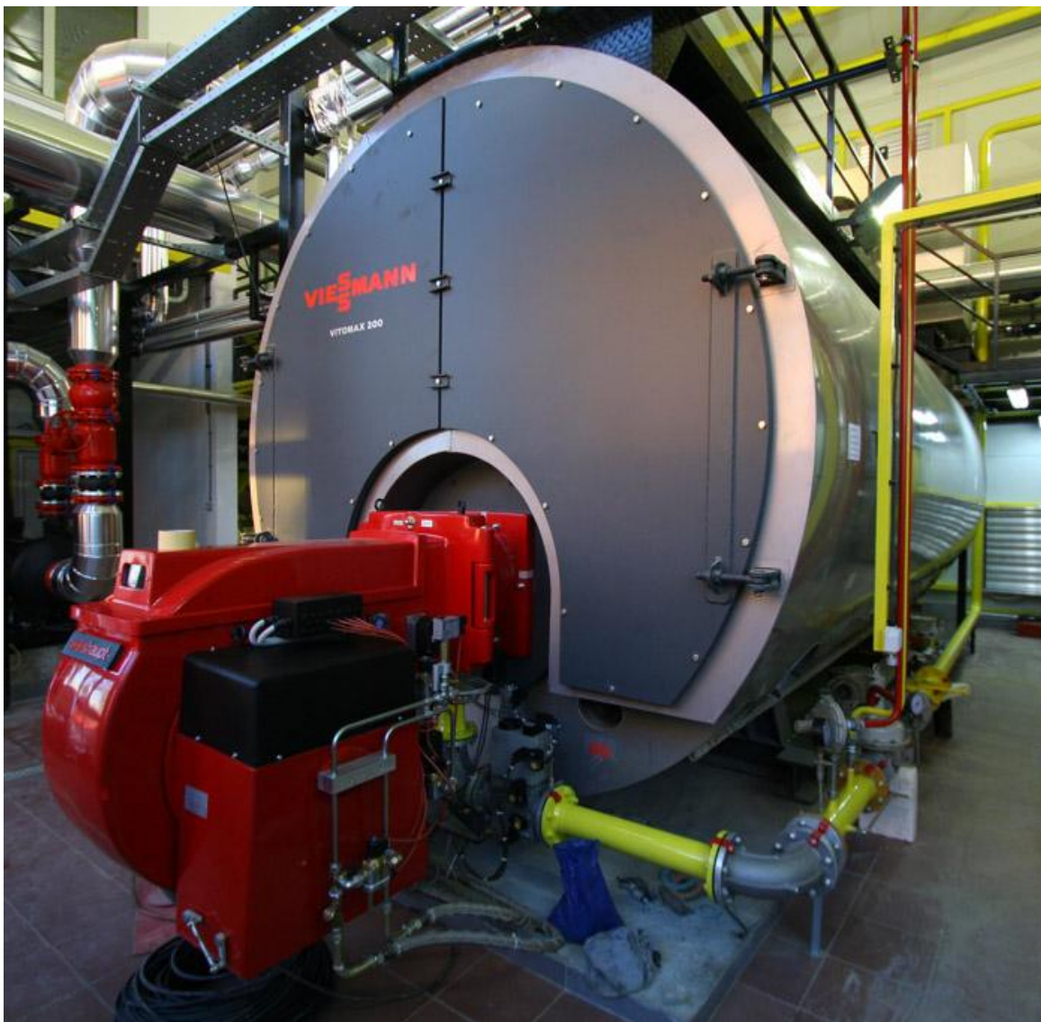
Слика 11 : Котло VISSMANN Vitomax 200 HW-4, тип M238
