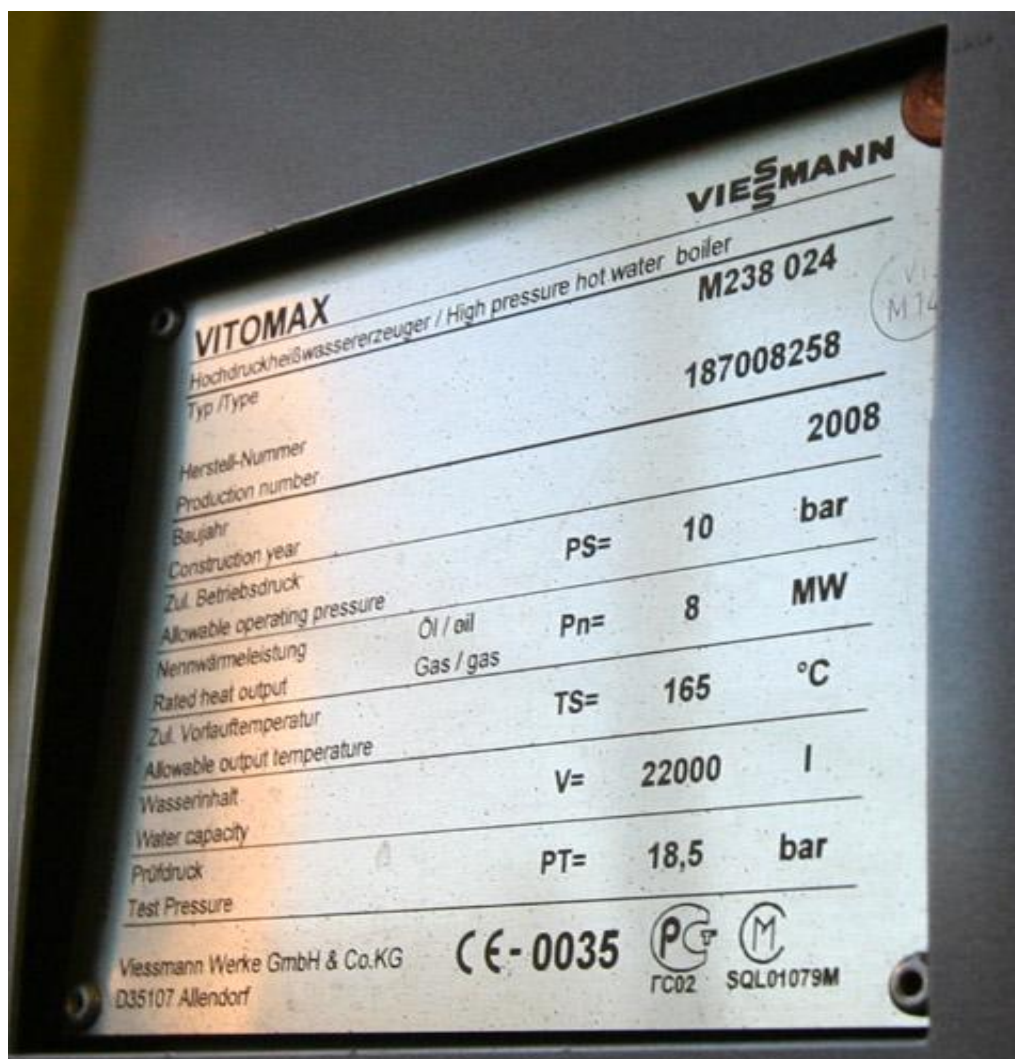
Слика 12 : Котао VISSMANN Vitomax 200 HW-4, тип M238
