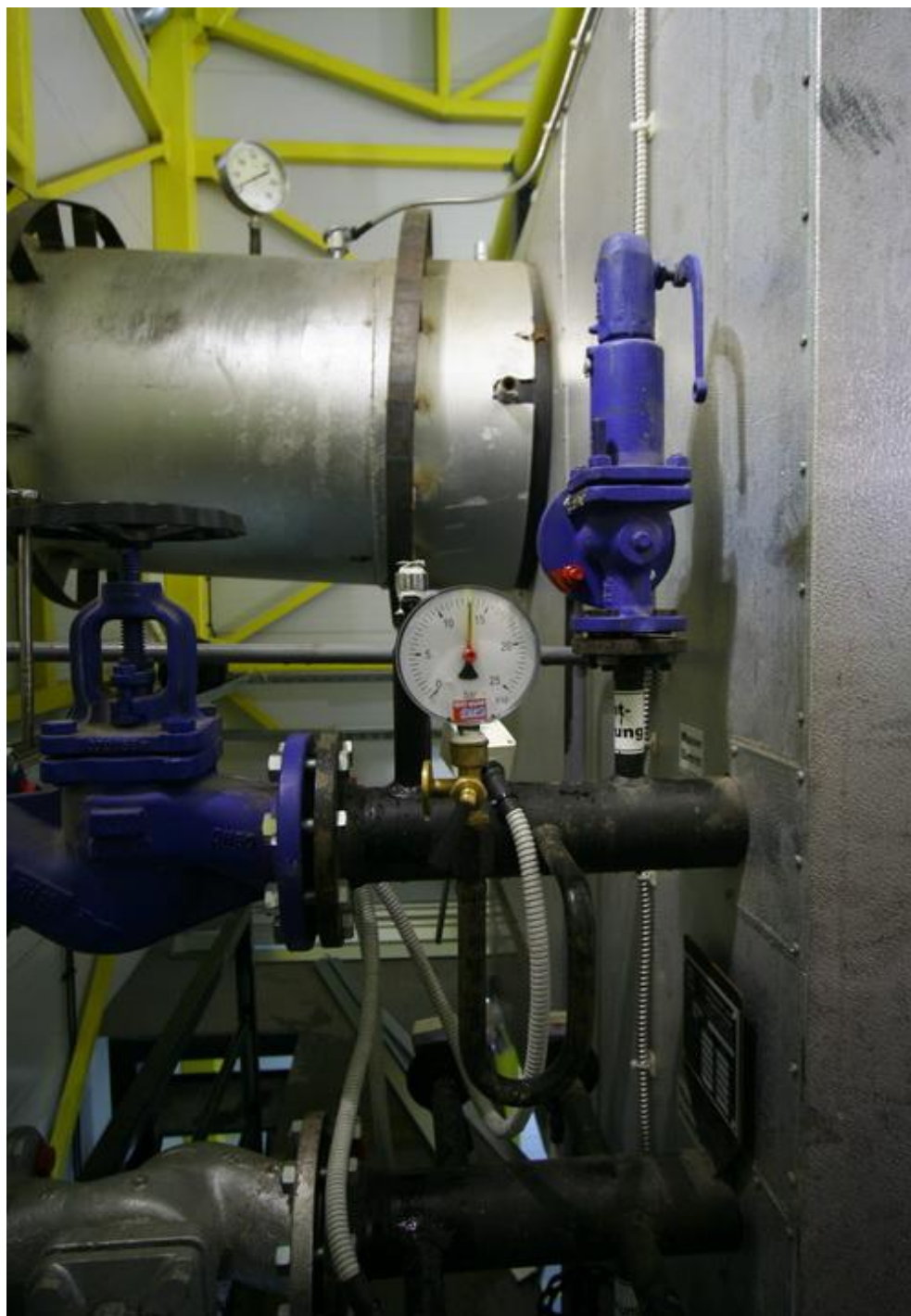
Слика 14: Сlike котларнице
