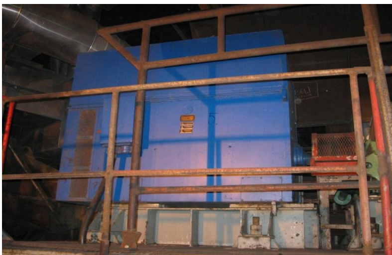
Слика 29. Електромотор вентилаторског млина
