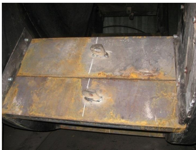
Слика 27. Ударне плоче вентилаторског млина
