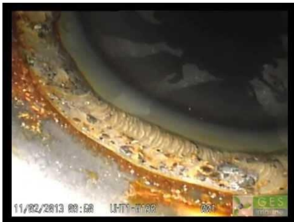
Слика 55. Визуелни преглед цеви при испитивању на корозију
