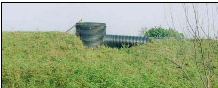
Слика 3.2.3. Ревизиона шахта на одводној линији OLB-III
