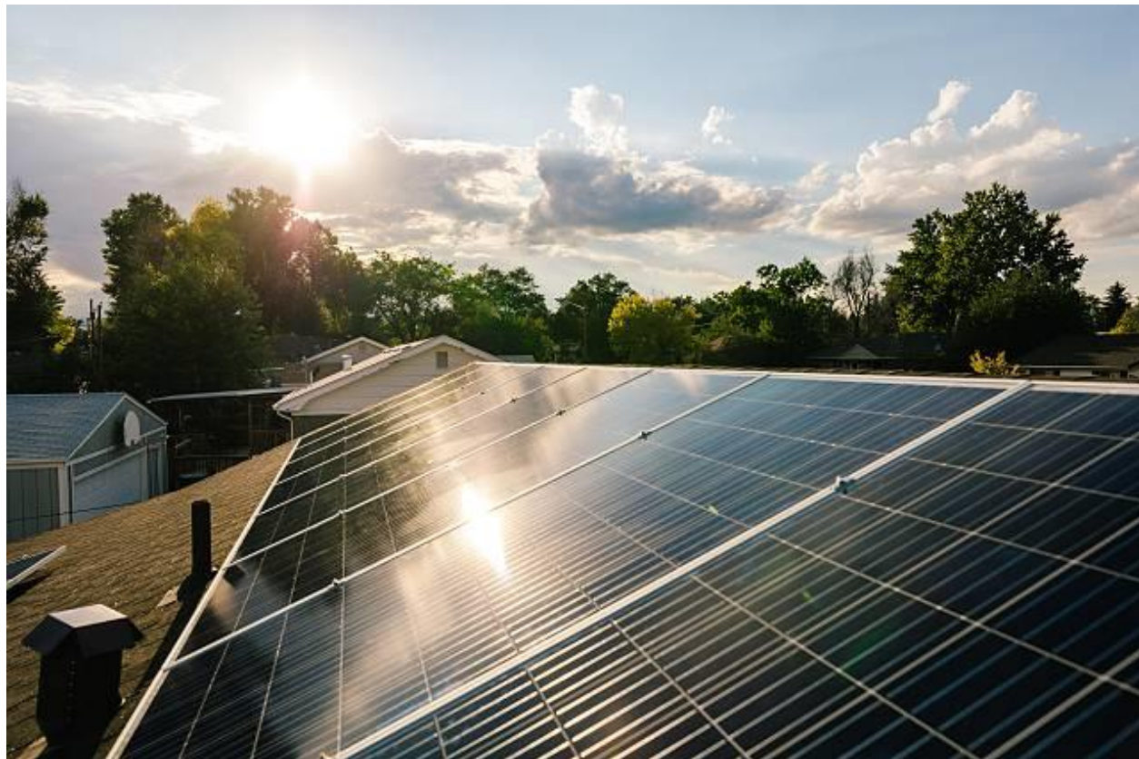
Слика 13 Соларни систем на крову пољопривредног објекта
