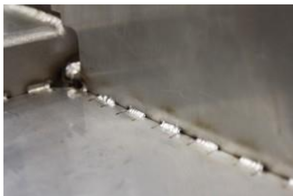
Слика 20 Дефекти израде -Пропуштени варови
