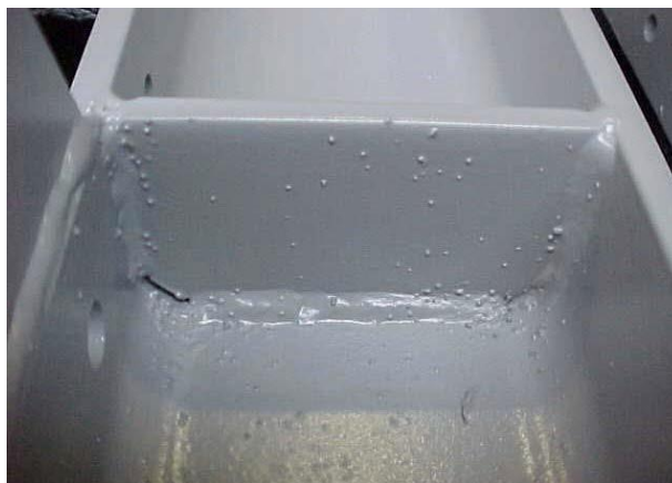
Слика 19 Дефекти израде-Шљака
