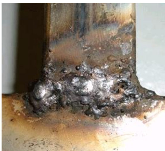
Слика 21 Дефекти израде –Грубо заварени спојеви
