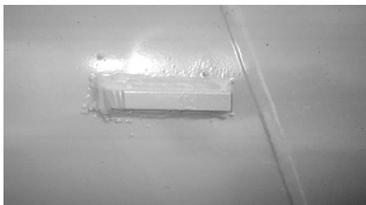
Слика 18 Дизајн дефекти- Конструкцијска помагала
