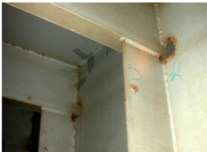
Слика 17 Дизајн дефекти-Оштре ивице
