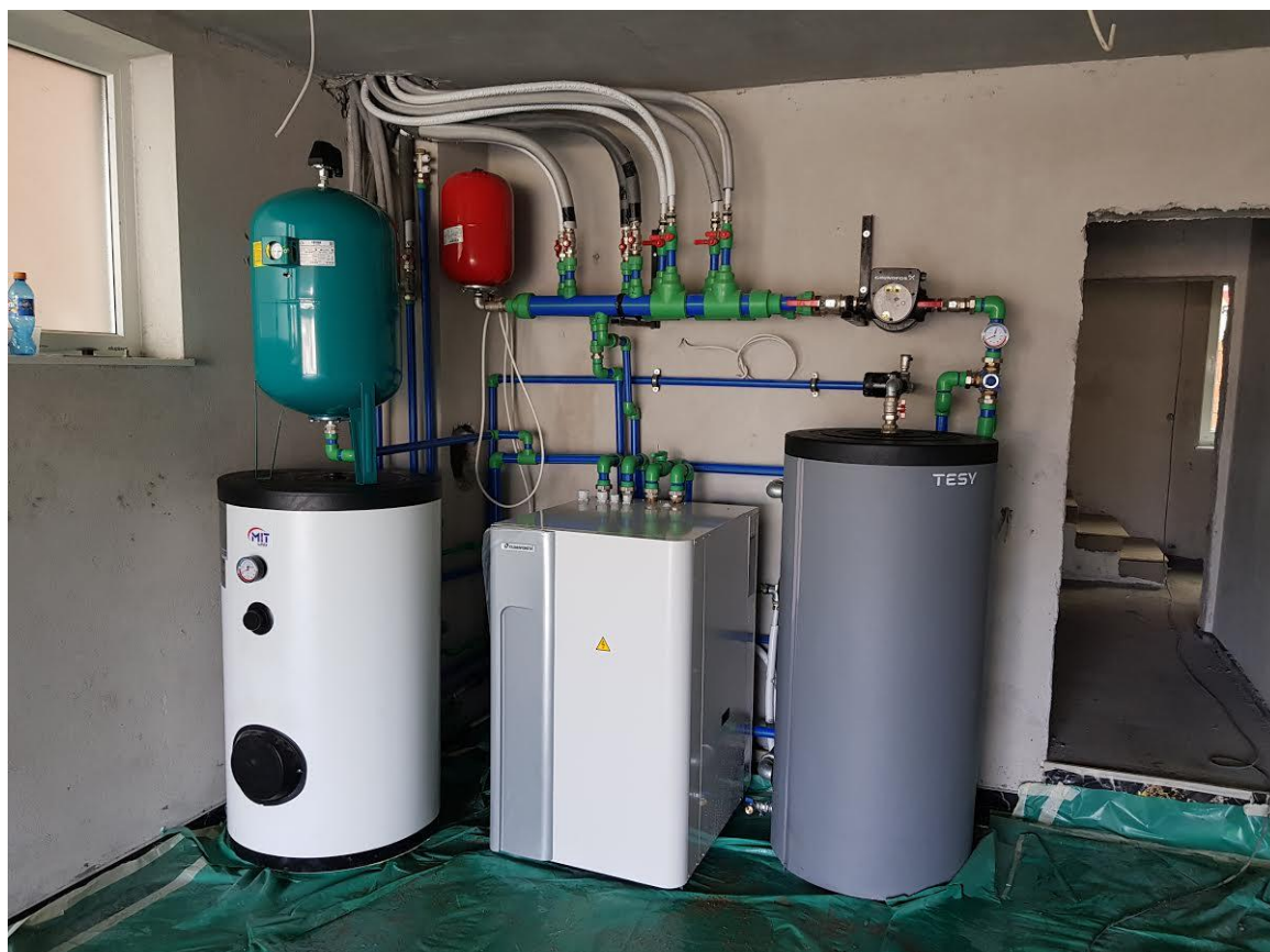
Слика 11. Топлотна пумпа вода – вода “Climaveneta“, бафер, бојлер. (Подстаница) [11]
