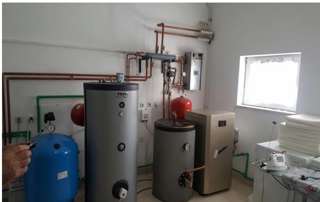
Слика 12. Топлотна пумпа вода – вода “Geotermika“, бафер, бојлер. (Подстаница) [12]
