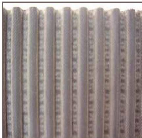
Слика 24. Изглед оштећеног омотача
