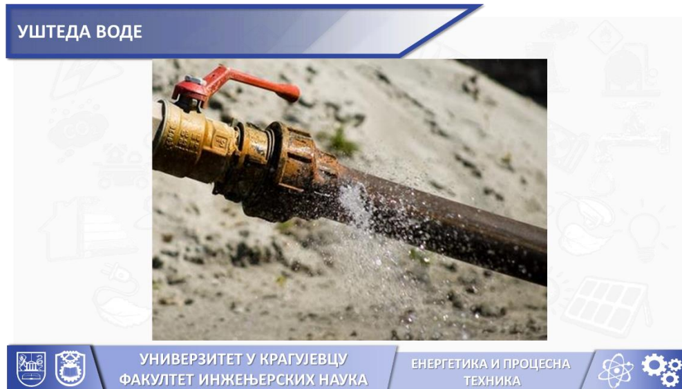
Слика 95. Цурење воде на спојници испред вентила [115]
