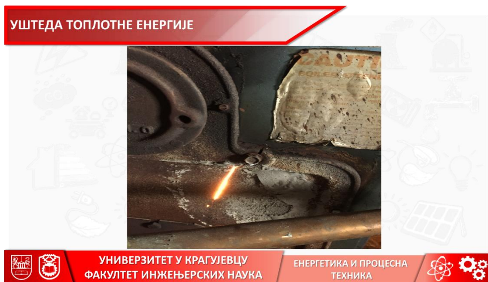
Слика 49. Пукотина на котловској конструкцији [99]
