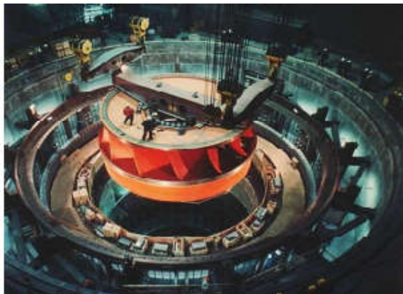
Слика 2.7 Коло Франсисове турбине у хидроелектрани снаге 750 MW
