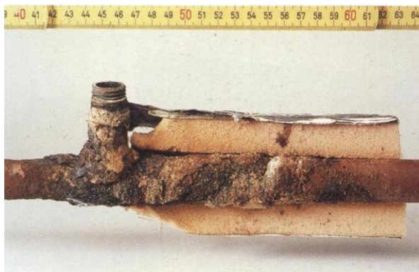
Слика 2.17 Корозија у зазору испод изолационе цеви на цеви од нелегираног челика
