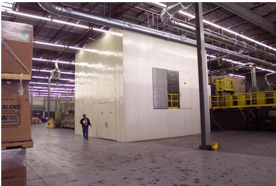
Слика 20. Пример звучно изолованог генератора[13]
