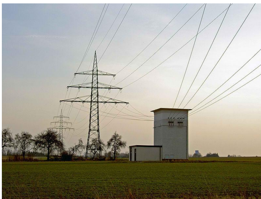
Слика 1: Дистрибутивна трансформаторска станица [2]
