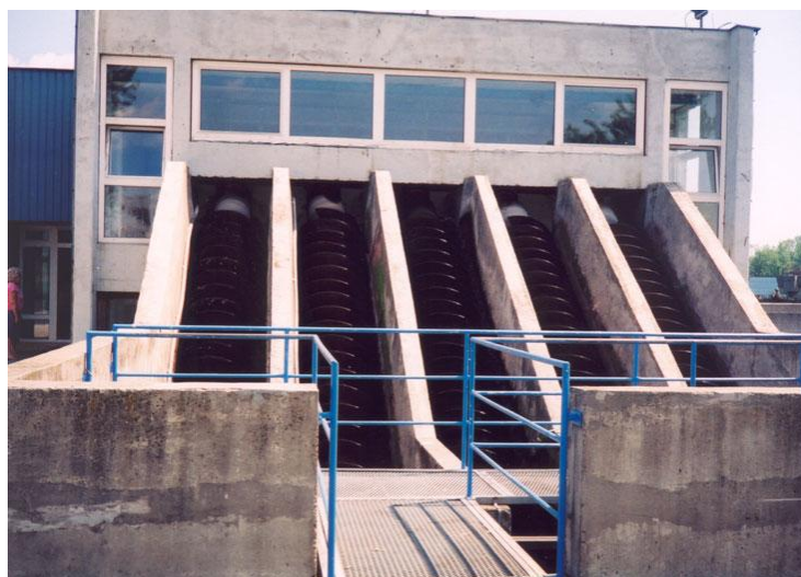
Слика 2.2.1.1 Црпна станица са пужним пумпама [6]
