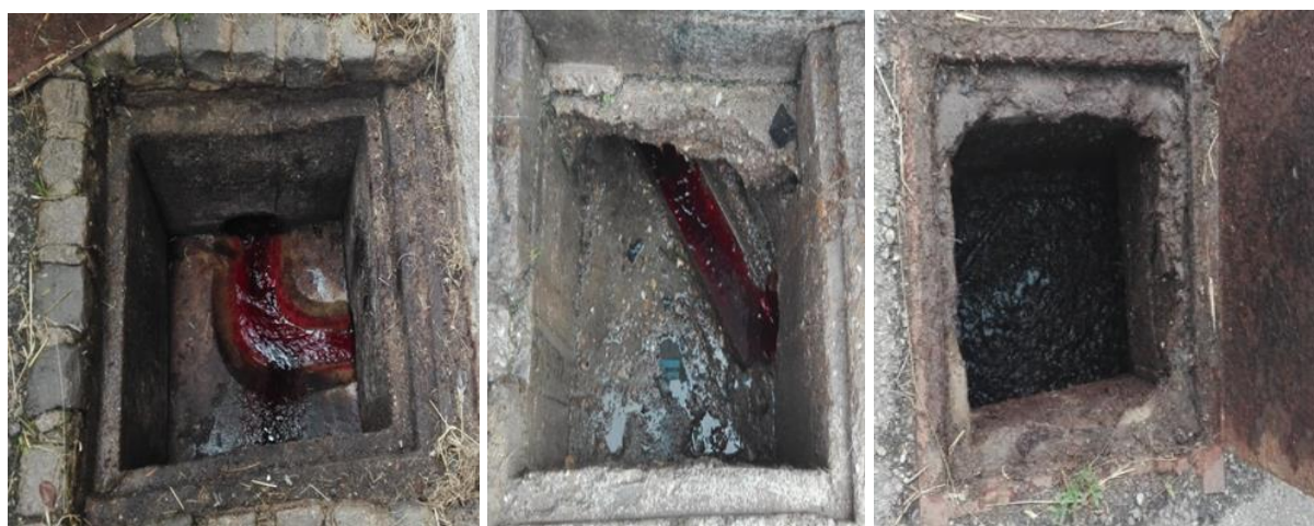
Слика 46. Преливне јаме за одвођење отпадних вода
