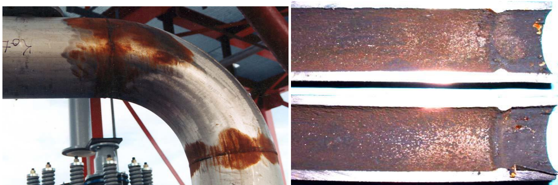
Слика 2.26 а) Општа корозија зоне завареног као последица грубе обраде површинског слоја, б) Општа кисеонична корозија заварени спој две цеви прикривен хематитом
