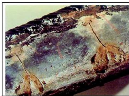
Слика 2.9 ПрсLINE као последица напонске корозије цеви; ПрсLINE је оштра и права - транскристална прсLINE
