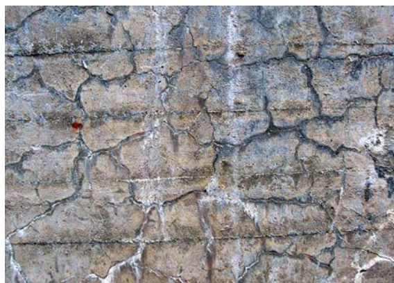
Слика 3.1 Корозија бетона
