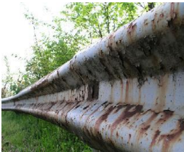
Слика 2.1. Појава опште корозија[8]
