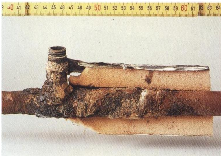
Слика 2.9. Корозија у зазору
