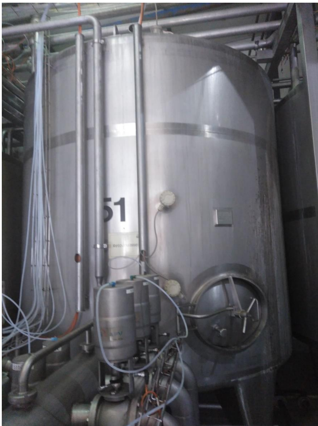
Слика 48. Резервоар азотне киселине
