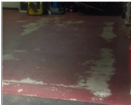
Слика 13. Лоше припремљена радна површина [13]
