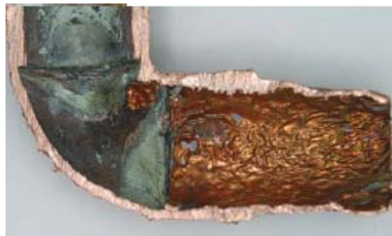
Слика 4.21 Изглед ерозионе корозије на једном машинском елементу
