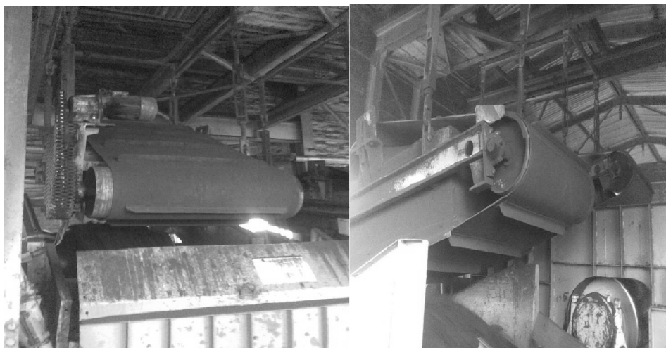
Слика 8. Електромагнетни издвајачи
