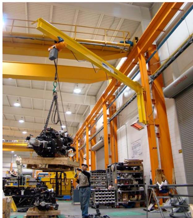
Слика 1.2 Коришћење зидне конзолне дизалице у индустрији [4]
