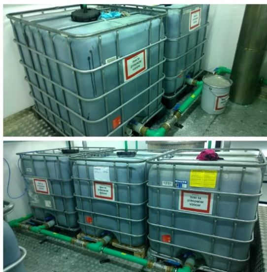
Слика 11. Централни резервоари укупне запремине 5000 литара
