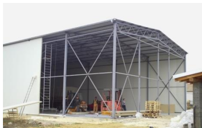
Слика 3.3 Изградња хладњаче са металном конструкцијом [18]
