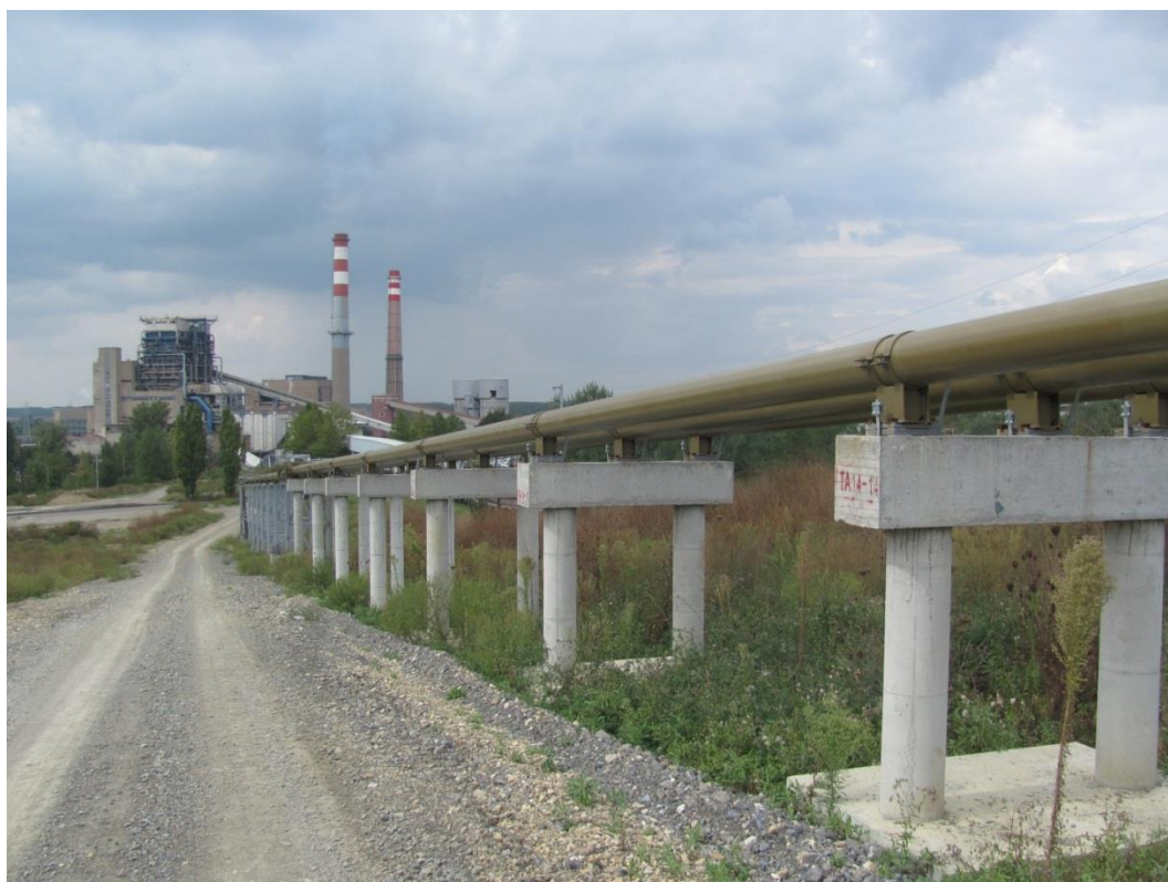
Слика 19 Приказ цеви (радна, резервна, и цев повратне воде) и термоелектране Костолац
