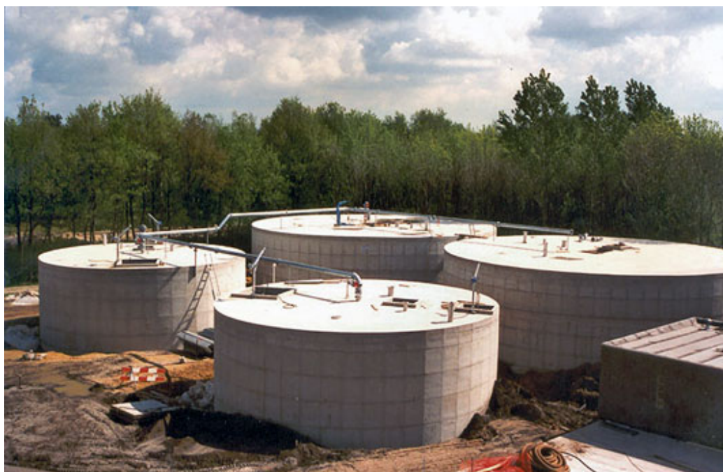
Слика 19 : Резервоари за складиштење стајњака
