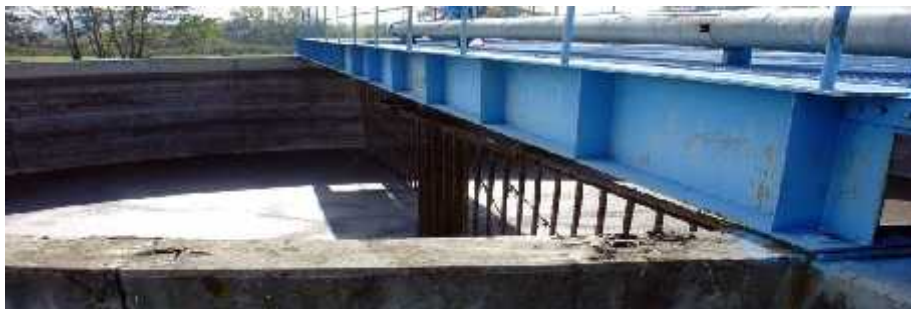
Слика17. Секундарни угушћивач
