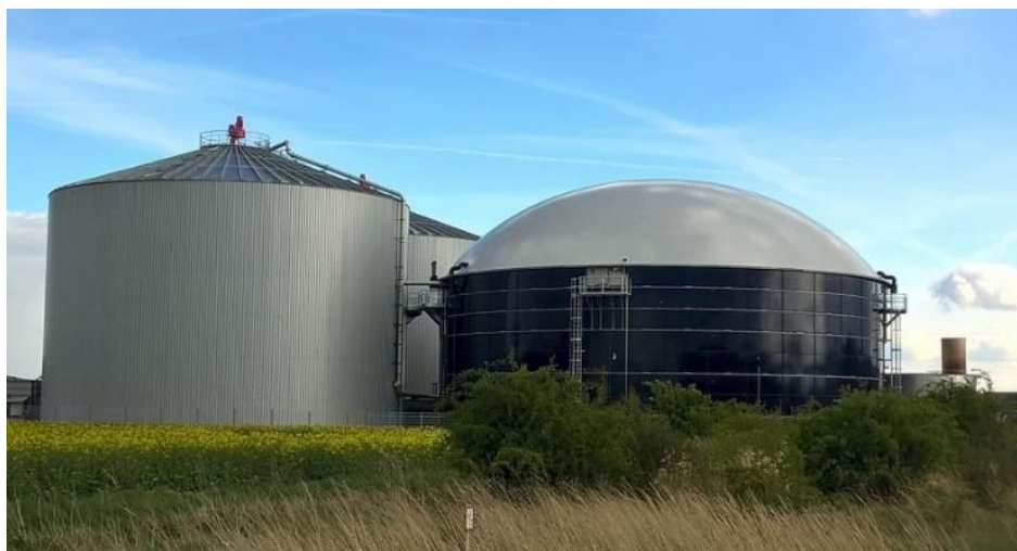
Слика 30. Биогасно постројење
