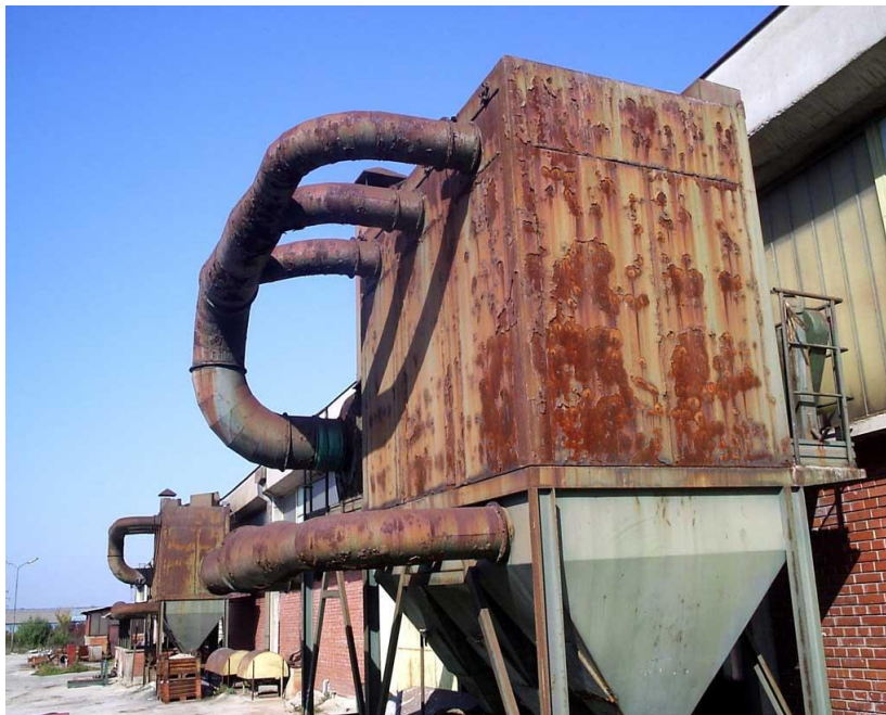
Слика 1.1 Пример појаве корозије [5]
