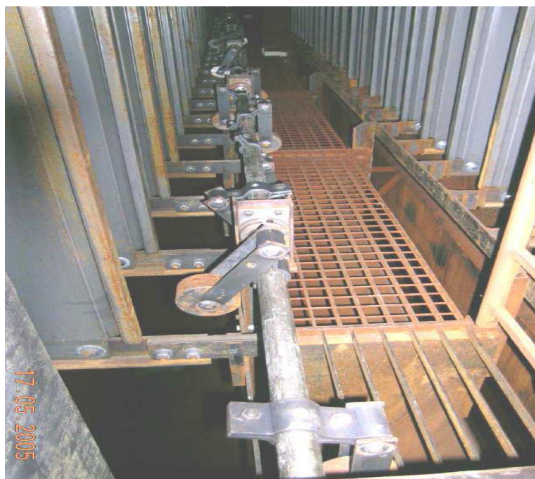
Слика 8: Колекторске (таложне) електроде
