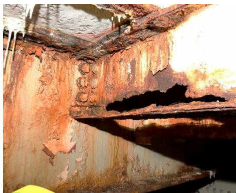
Слика 2.Изглед металне конструкције изложене корозији , [13]
