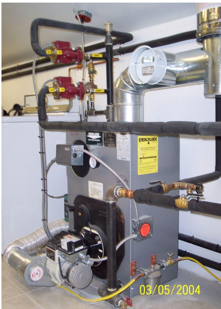
Слика 5.17 – Пример кућног котла за грејање топлим ваздухом [13]
