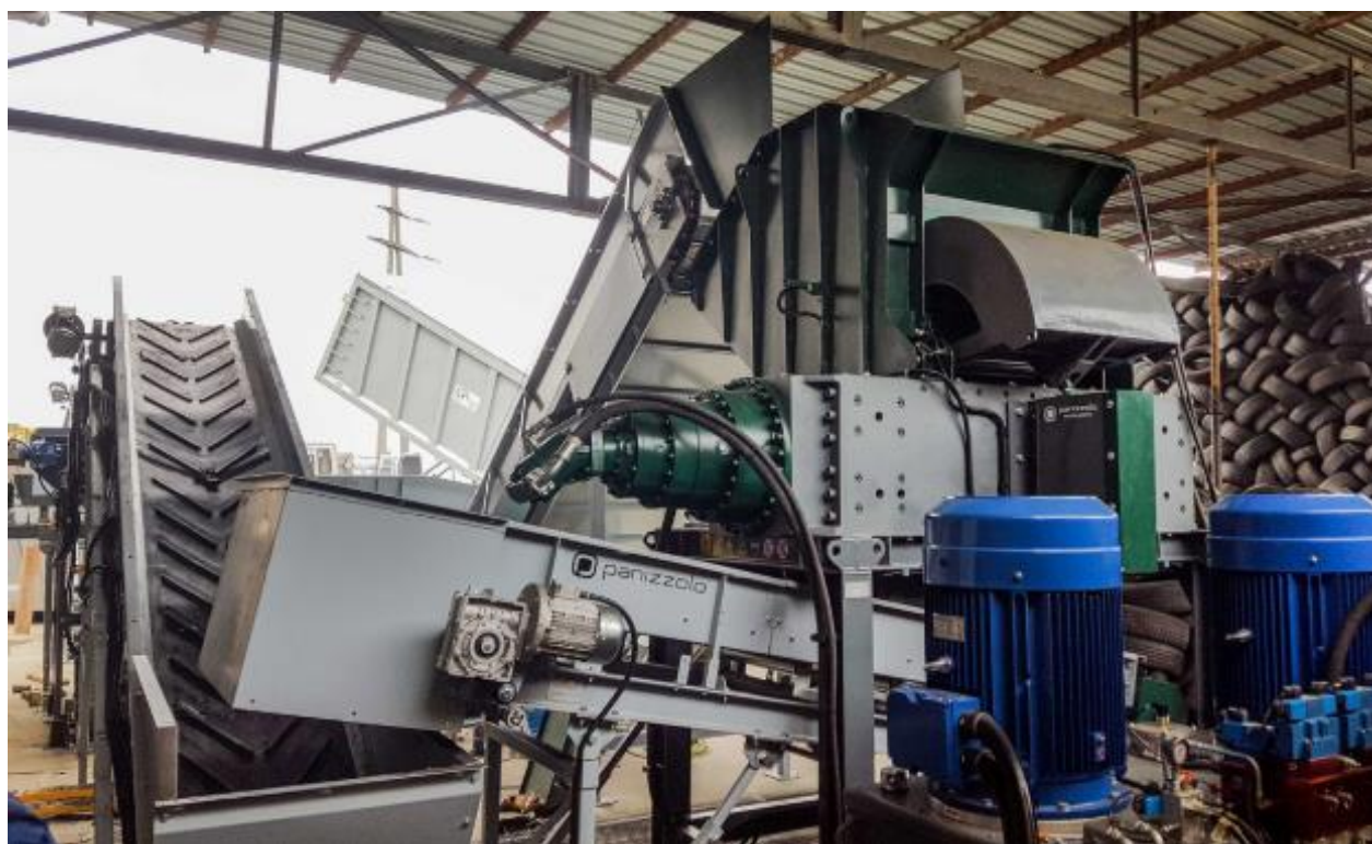
Слика 31. Унутрашњост постројења
