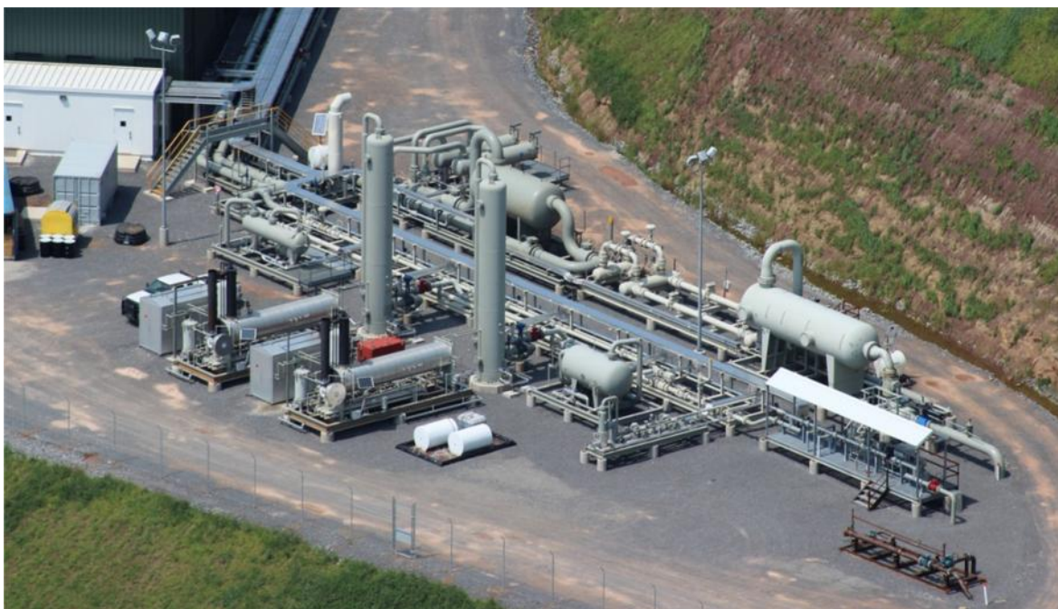
Слика 10.3 Компресорска станица
