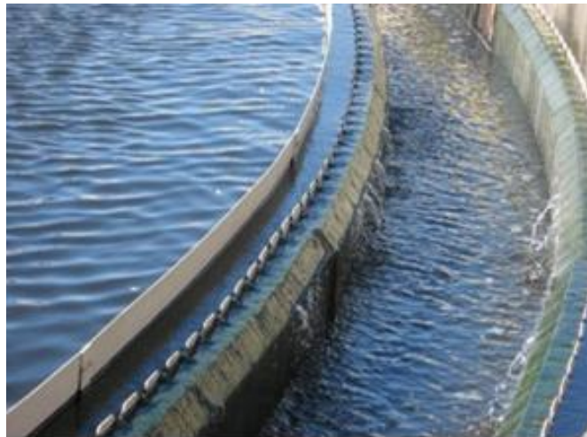
Слика 6.15. Одвајање воде од муља у секундарном таложнику
