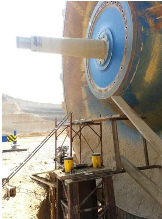
Слика 14-Вратило радног точка након демонтаже редуктора радног точка
