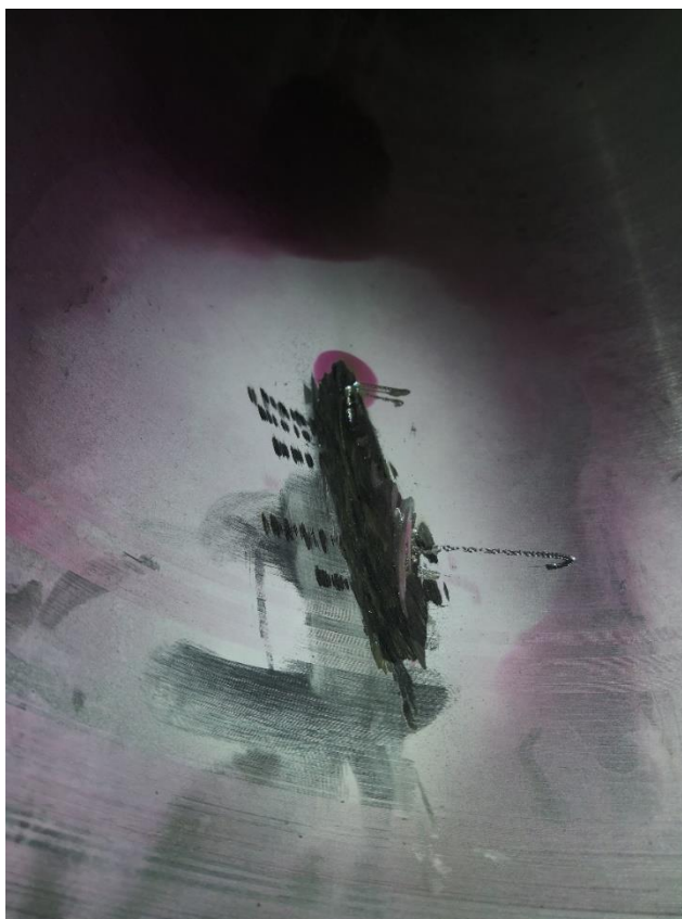
Слика 6.11 Изжлебљена прсLINE до "здравог" материјала
