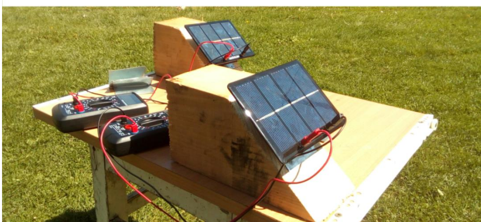
Слика 17.- ПВ панели у експлоатацији
