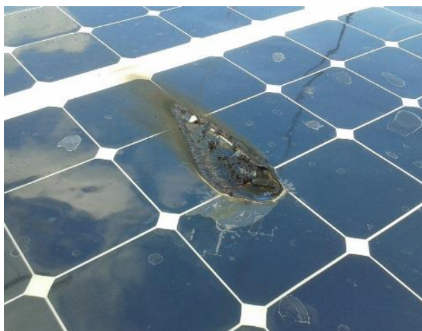
Слика 37. Изглед оштећења услед вруће тачке
