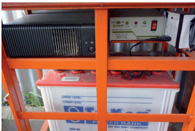
Слика 8.6. Горe лево: електронски контролисан пуњач акумулатора; горе десно: Стабилизатор напона; испод: Олововни акумулатор [18]
