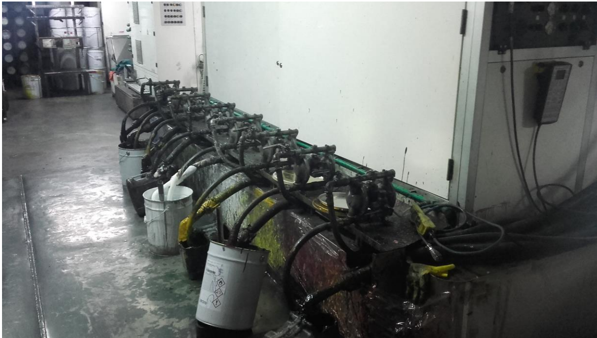
Слика 4.8. Систем пумпи и вентила за нанос боје
