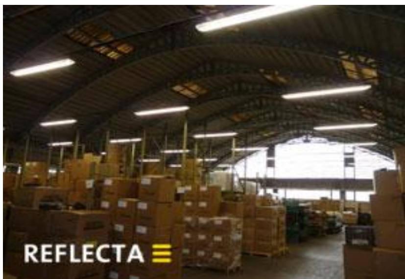
Слика 2.4 Осветљење хале
