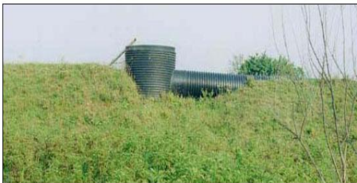
Слика 4.5. Ревизиона шахта на одводној линији OLB-III
