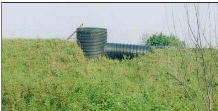
Слика 2.5. Ревизиона шахта на одводној линији
