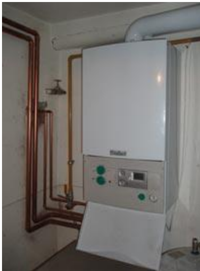
Слика 7. Извор топлоте(гасни котао)
