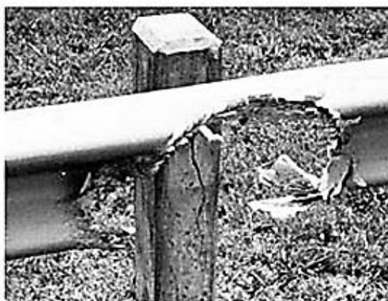
Slika 66: Primeri galvanske korozije: a) galvanska korozija nosećeg stuba u konstrukciji, b) galvanska korozija cevi, c) galvanska korozija stuba i ograde pored auto puta
