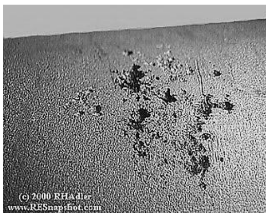
Slika 46: Korozija – piting: a) - d) primeri pitinga cevi
